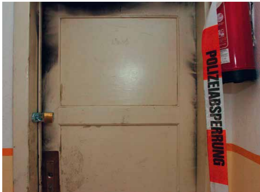
Blick auf die Tür der Asylunterkunft in Sangerhausen nach dem Brandanschlag am 6.1.2007 (Foto: Uwe Gellert)
